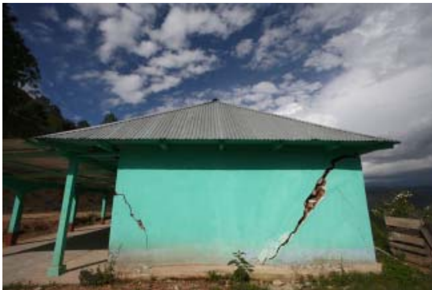
Risse in einer Hausmauer in der Nähe der Mine Marlin in San Marcos
